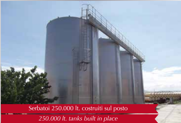
Serbatoi e Sovrastrutture / Tanks and Walkways
