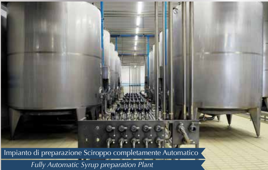
Sala Sciropo completamente automatica Fully automatic Syrup Room
